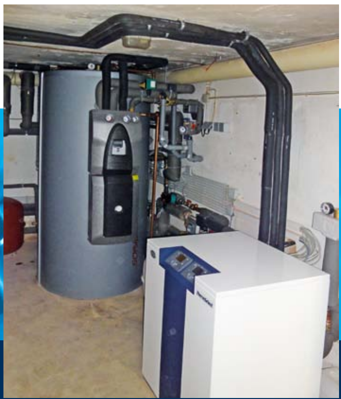
Hoch effizient und umweltschonend: Blick auf die fertig installierte Heizungsanlage
