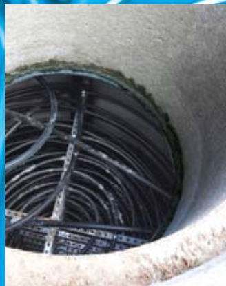
Die PE-Rohre dienen als Wärmeübertrager für Solarenergie und die quellenseitige Energieentnahme für die Wärmepumpe.
