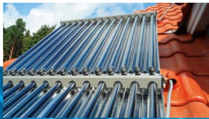
Die thermische Solaranlage ist mit sechs Röhrenkollektor-Panels mit einer Gesamtfläche von 15 Quadratmetern ausgestattet.
