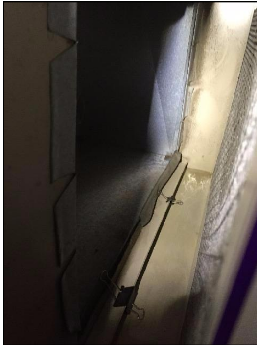
20. Loose or collapsed
