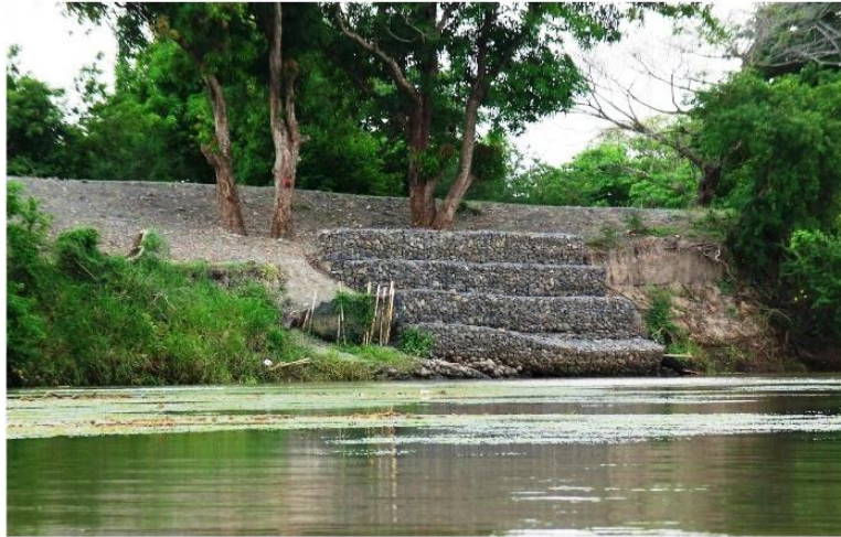
Figura 25. Daños en la borda a la orilla del río Lempa
