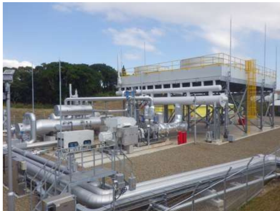
メディポリス指宿地熱発電所
