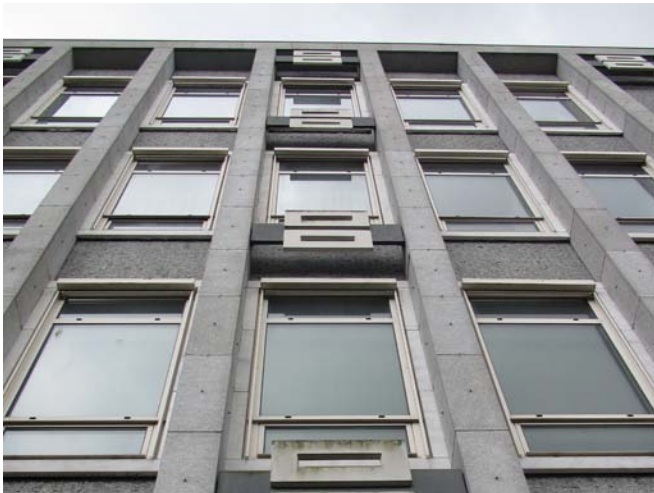
Kozijnen met screens
