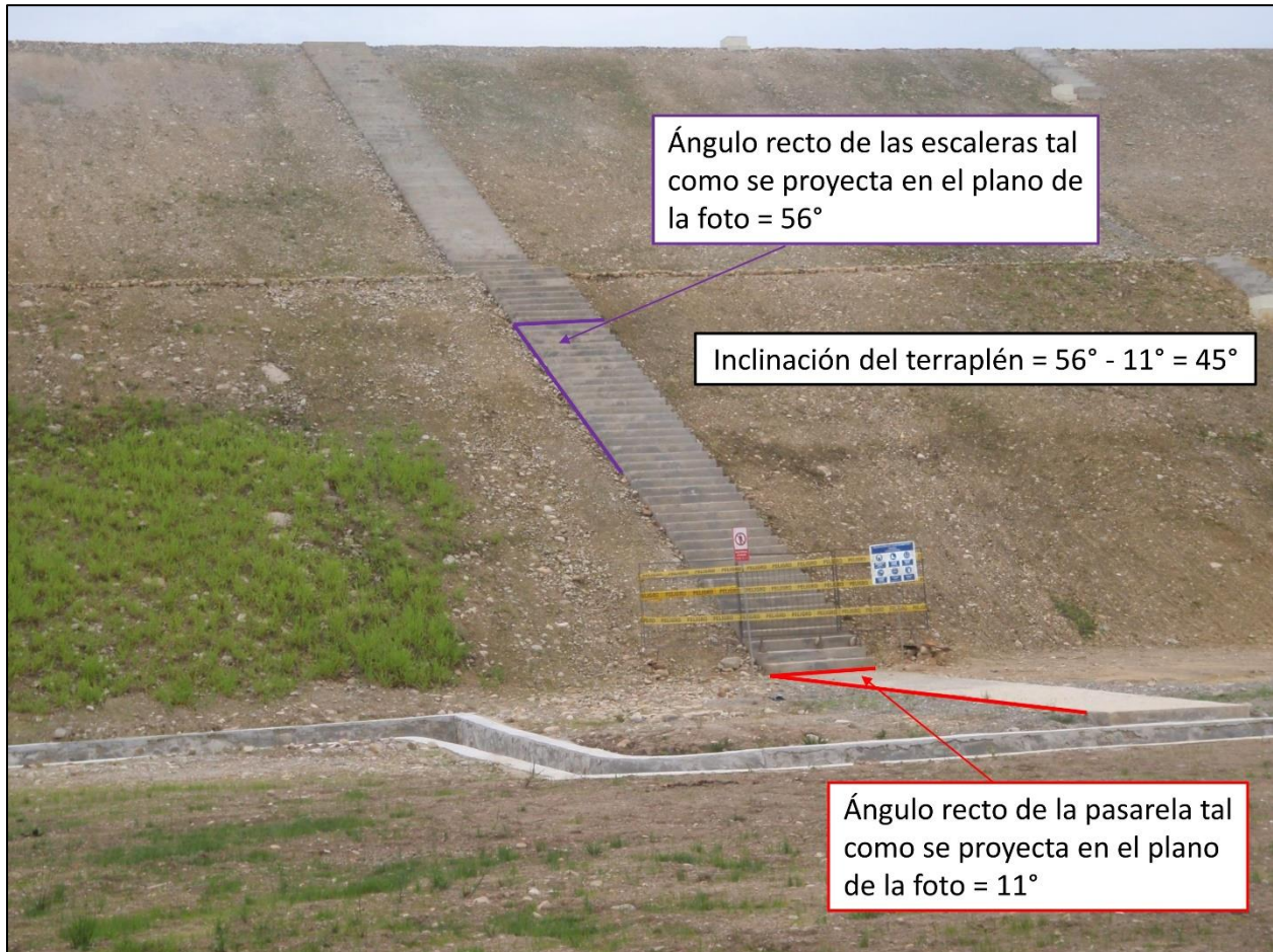
Figura 17. El dique inicial para la presa de la relavera Quimi tiene una inclinación de 1V:1H (45°). Esto es inconsistente con el diseño evaluado por Knight-Pièsold (2007; ver Figura 10) y ambos Estudios de impacto ambiental, los cuales establecieron que la inclinación sería 1V:2H (26,6°). Una inclinación de 1V:1H se considera el ángulo máximo crítico para prevenir la erosión interna de la presa sin ninguna margen de error (factor de seguridad = 1,0). En contraste, según el Cuerpo de ingenieros del ejército de los EE. UU. (USACE, 2000), “para los diques de arena, una inclinación aguas abajo de 1V en 5H [11,3°] se considera lo suficientemente plana como para evitar daños por infiltración que salen de la pendiente aguas abajo [erosión interna]”. Foto tomada por el autor el 6 de noviembre de 2018.
