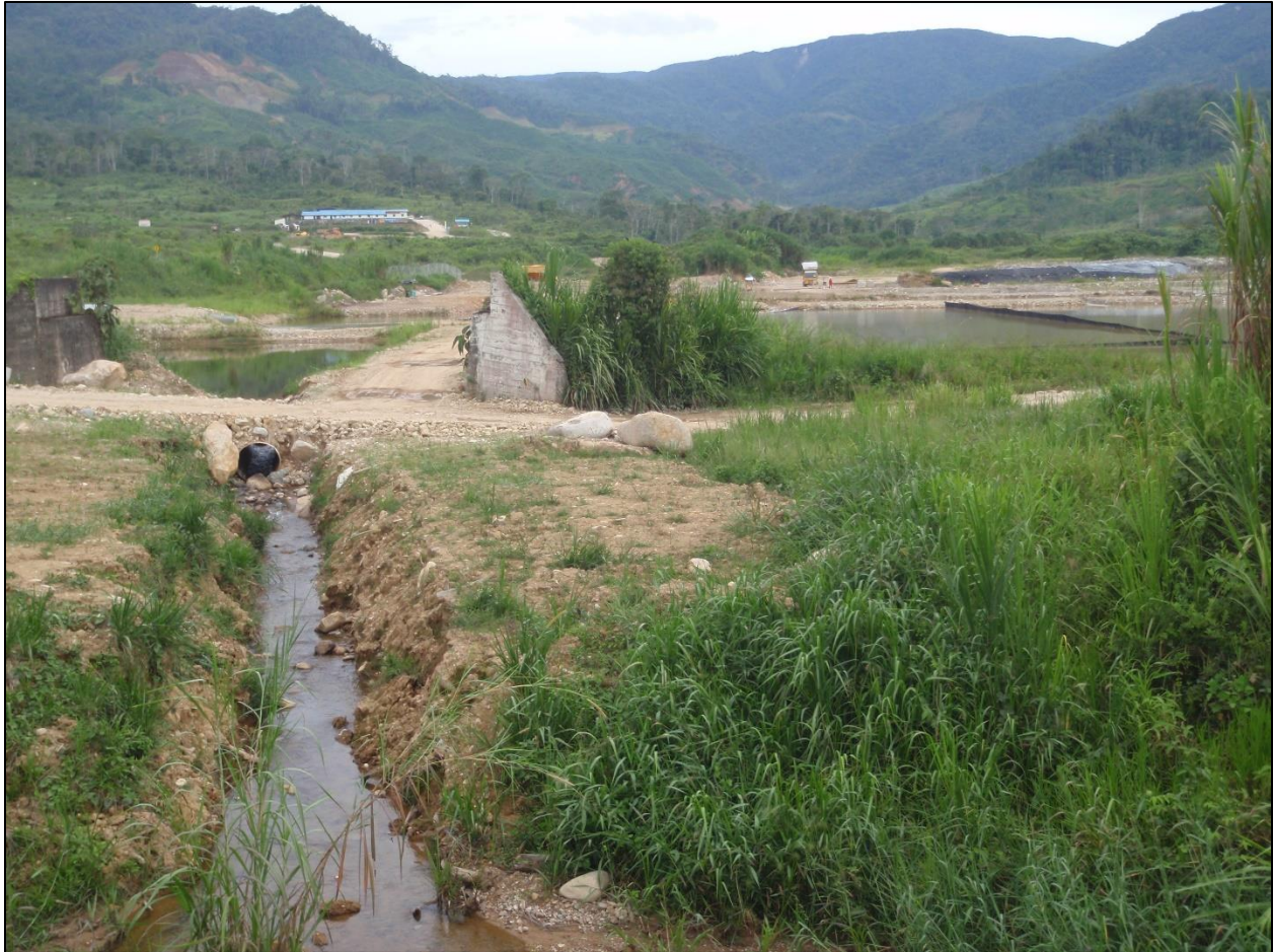
Figura 19c. El color gris de la descarga de las piscinas de sedimentación demuestra que las piscinas de sedimentación no funcionan (Quishpe Lozano et al., 2018). Foto tomada por el autor el 6 de noviembre de 2018.
