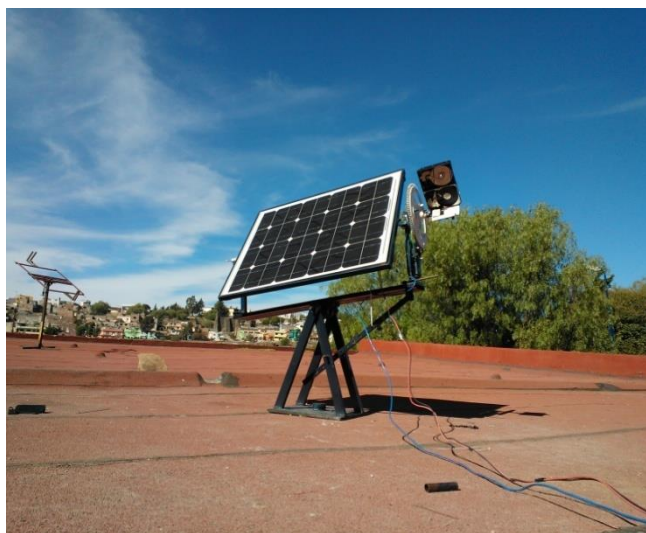
Figura 22. Panel solar conectado mediante cable UTP a la consola NI ELVIS.
