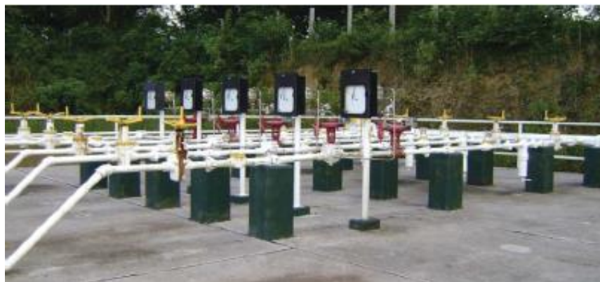
Fig. 1 Manifold de Inyección de Gas
