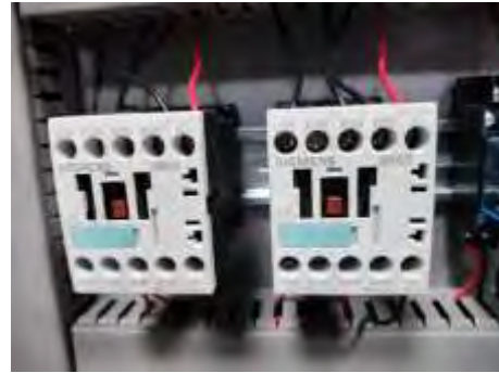
Figura 8. Contactores en el Módulo Didáctico.
