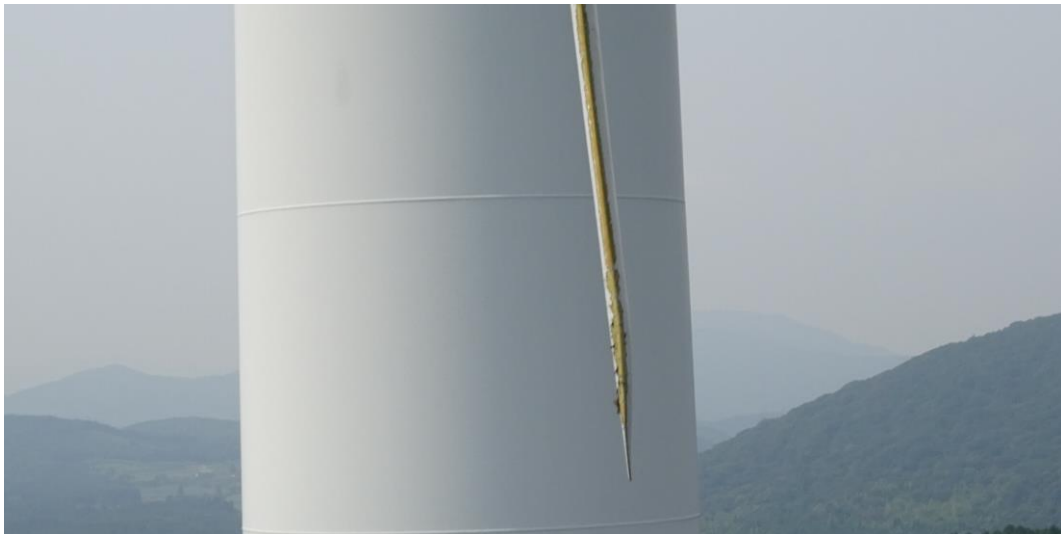
(例：ブレードのエッジ部分の塗装が剥離 @ 穎娃風力発電所)
