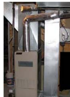
Figure 5 : Générateur d'air pulsé
