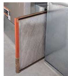
Figure 6 : Filtre de la chaudière
