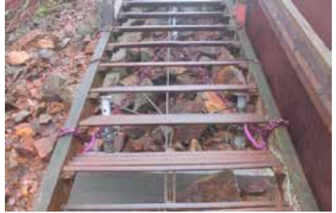
Støping av fundament for understøttelse av trapp. Flere doble støtter under trappen og ekstra sikkerhetswire.
