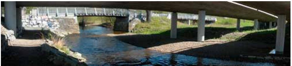
Ny Kølabrø har gitt mindre oppstuvning av flomvann oppstrøms og redusert flomfaren.
