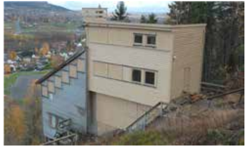
Alle vinduer i dommerhuset er helrestaurert. Tre vinduer på sydveggen var råtnet og er skiftet ut.
