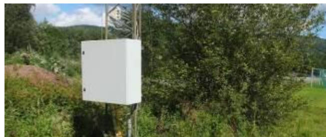
El-skap på nederste lysmast etter overgangen med ny kabel for gjeninnkobling av tre utkoblede lyskastere.
