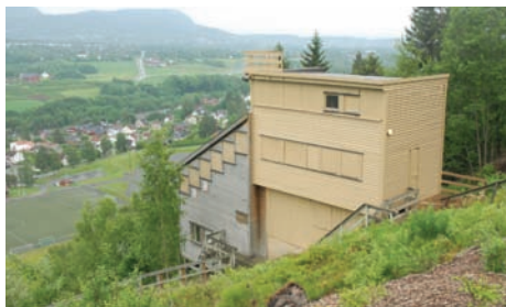
Dommerhuset har fått nytt tak, nå også på nedre nyeste del og er vasket og ferdig malt.
