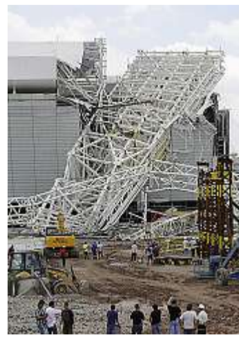
Das Dach des Stadions in São Paulo stürzte ein. Keystone
