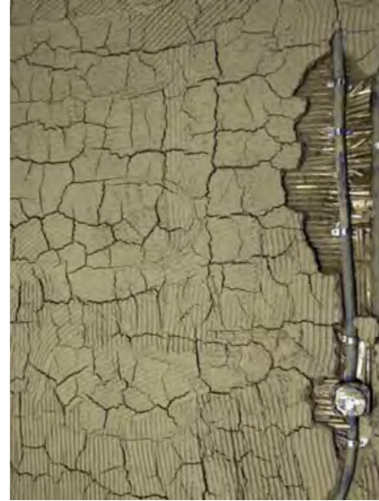
Die getrocknete 1. Schicht mit den typischen Rissbildungen. Die Elektro- und Wandheizungsinstallation auf der Holzkonstruktion.
