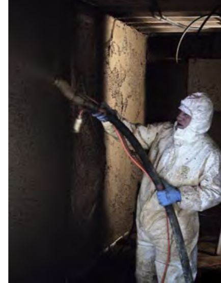
1. Lage Lehm wird auf die Holzkonstruktion, auf welcher eine Schilfmatte als Träger gelegt wurde, gespritzt.
