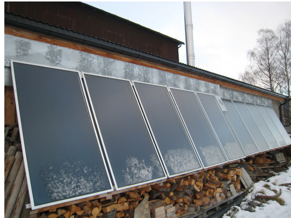
SOLFANGERE I KOMBINASJON MED VED-KJEL PÅ GÅRDEN SØRE KVÅLE I SKJÅK
