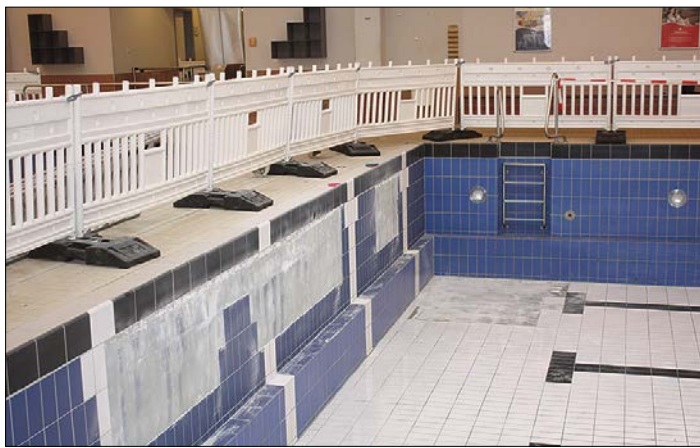
In allen Becken sind die Schäden deutlich erkennbar.
