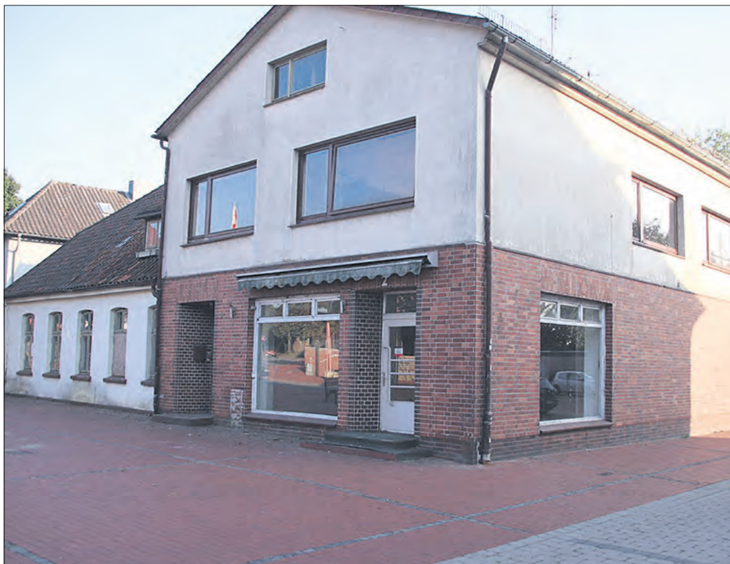
Alles andere als ein Augenschmaus: die „Alte Schlachterei“ in der Schneverdinger Innenstadt. Die Mehrheitsgruppe SPD/Grüne spricht sich für den Abriß des maroden Gebäudes aus und regt, was die künftige Nutzung des Grundstücks angeht, einen Ideenwettbewerb an, um die Bürger der Stadt einzubinden. Foto: Timo Maab
