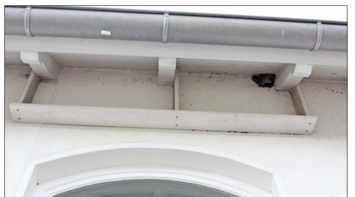
Um den Schwalben das Brüten zu ermöglichen, ohne daß sich irgendjemand belästigt fühlt, hat die AWS in der Vergangenheit sogar in einigen Bereichen Kotbretter installiert. Foto: mwi
