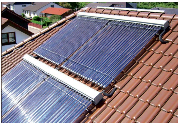
Dank neuer Austauschröhren erstrahlt die alte Vakuumröhrenkollektoranlage wieder in neuem Glanz und kann ihre Arbeit weiterhin ausführen. Werkfoto: AkoTec
