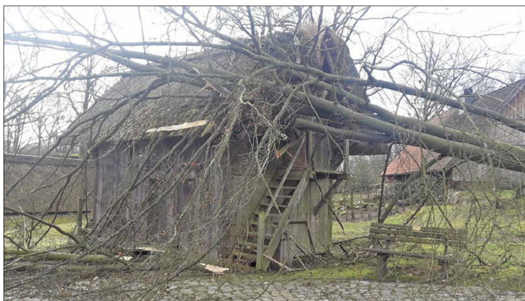
Das Sturmtief fegte auch durchs Naturschutzgebiet: Ein Treppenspeicher auf dem „Emhoff“ in Wilsede wurde durch eine umgebrochene Buche beschädigt. Foto: VNP-Stiftung
