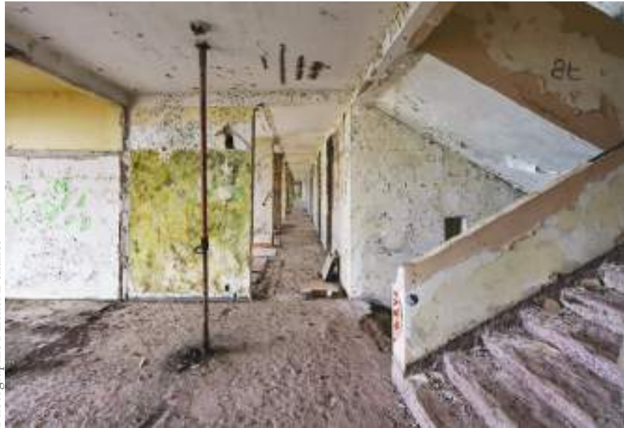
Couloir de distribution au 1 er étage Désagrégation des dalles et étaie- ment provisoire
