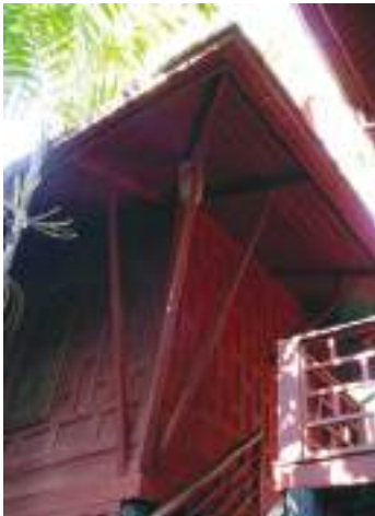
Aisseliers supportant la toiture en débord de la maison du décorateur Jim Thompson à Bangkok. Photo février 2016
