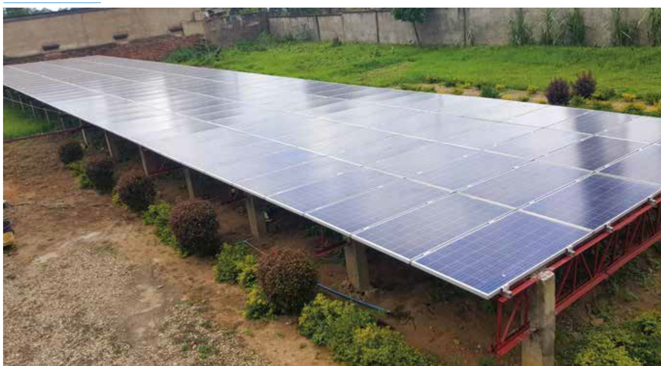
Le système solaire de 55 kW de Kivu Green Energy à Beni, dans le Nord-Kivu.
