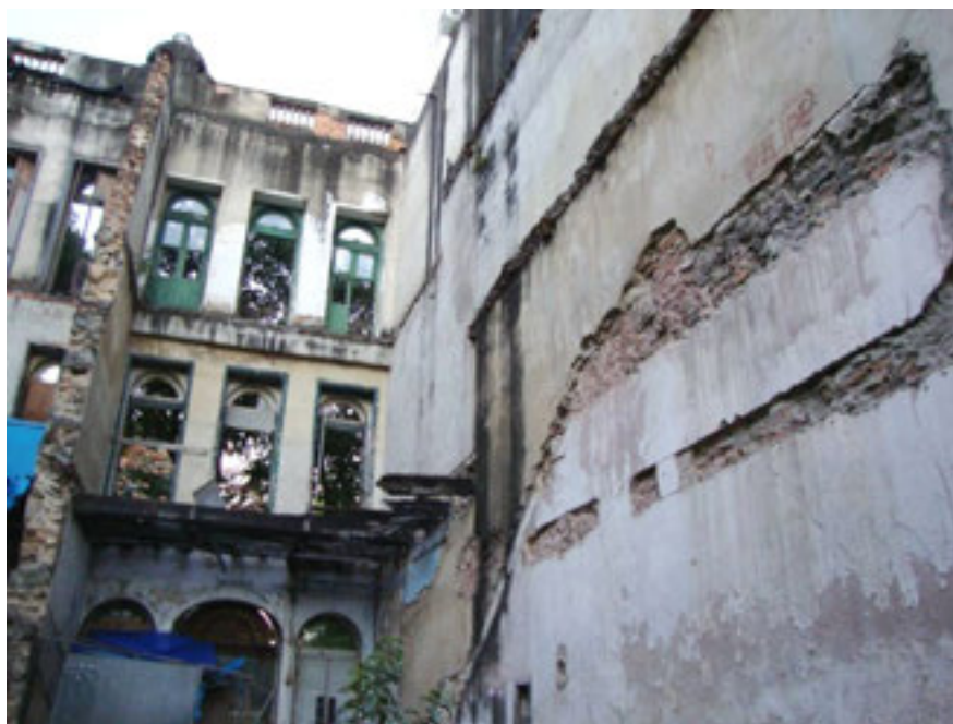
Foto 1.6 – Ruínas da antiga Gafieira Estudantina, com as marcas da escadaria e do segundo piso na parede do imóvel vizinho.
