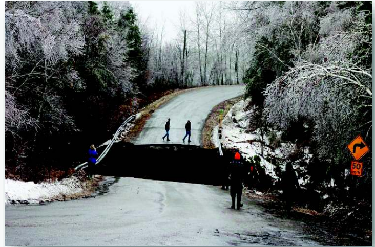
Figure 3-10 - Exemple de faillite de l'infrastructure [17]
