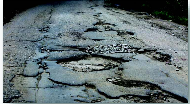
Figure 3-19 - Exemple de détérioration des routes causée par le gel-dégel
