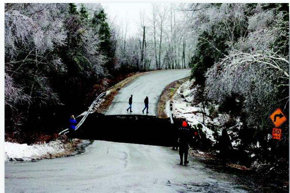
Figure 1 - Exemple de faillite de l'infrastructure
