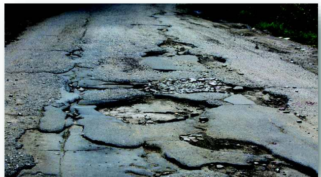
Figure 4 - Exemple de détérioration des routes causée par le gel-dégel
