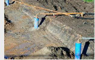
Depuración, potabilización y recuperación de aguas
