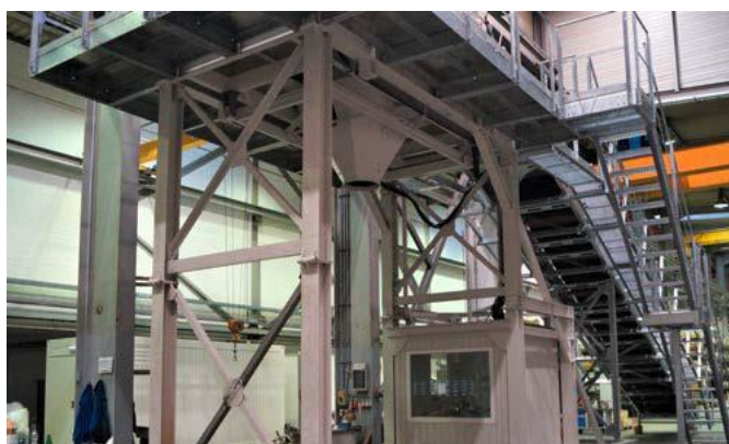
Estrutura da central com suportes, passadiços e escadas, como também cabine integrada.
