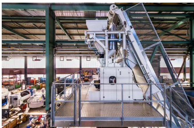
Plataformas de serviço e manutenção garantem melhor acessibilidade.
