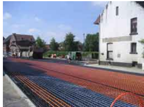
Zonnecollector in het asfalt
