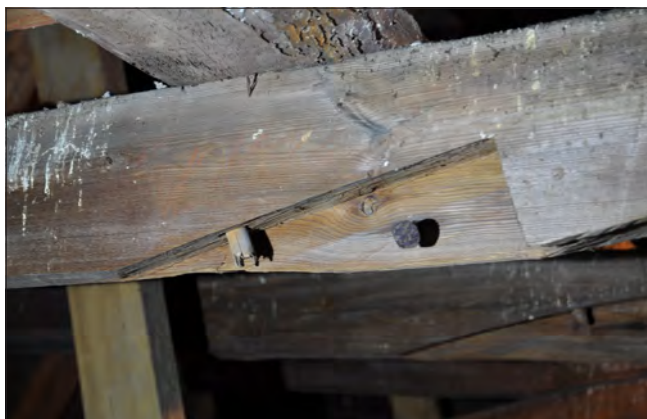
Figur 19. Urtag i hanbjälke för valvbåge i taksstol nr 7. Bågen har varit infäst med spik i sidled och tränagel (liten trädymling) från undersidan. Foto Daniel Eriksson.
