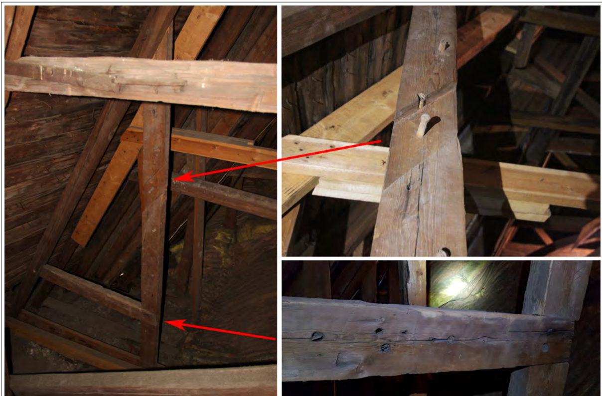
Figur 13. Delar av takstol nr 14, norra sidan, sedd från väster. Stickehjälken är kraftigt rötskadad och brädor har laskats på vardera sida, i de fragmentariska resterna syns dock flera dymlingshål. Bilderna till höger visar på spår efter inklädnad som varit infäst i andra delar. I en av dymlingarna sitter en kil.
