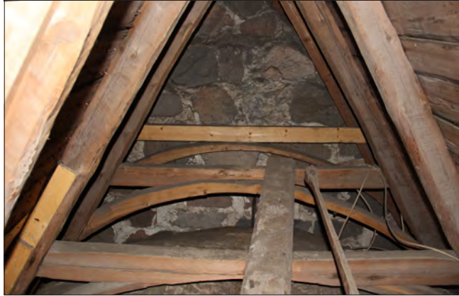
Figur 31. De två takstolarna mot väster med hela böjda ämnen i valvbågarna i vapenhuset.
