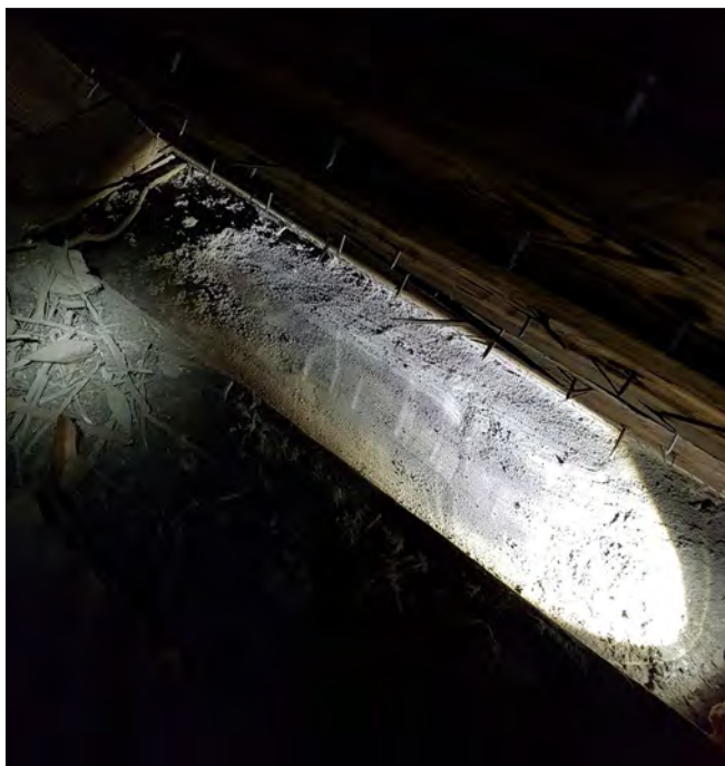
Figur 35. I takfoten utmed hela östra sidan, och i delar av den västra, finns ursprungliga medeltida takfotsbrädor kvar.
