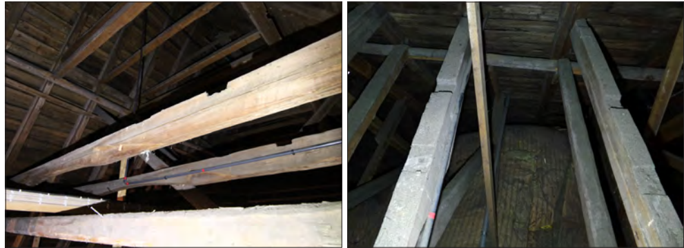
Figur 28. Urtag i hanbjälkarnas ovansidor, eventuellt för den takryttare som togs bort 1715. Till vänster visas takstol nr 18 och 19. Foto Lisa Skanser. Bilden till höger visar urtag ovanifrån. Foto Bengt Bygdén.
