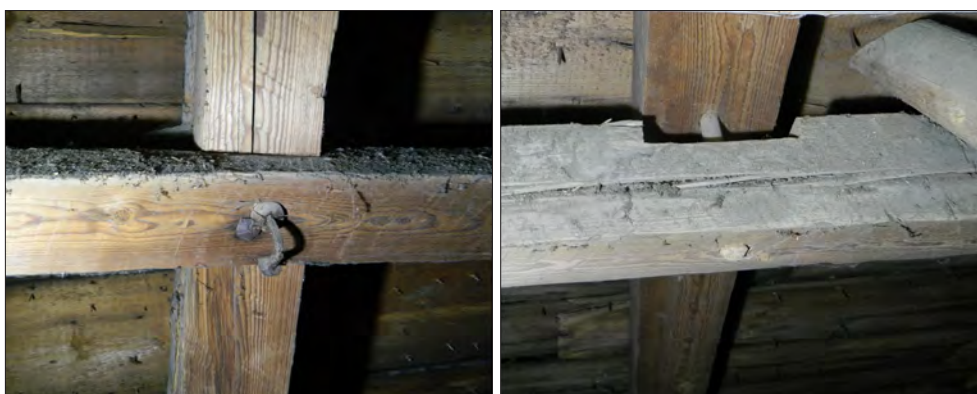
Figur 21. Detaljer av monteringsreglar. Till vänster har dymlingen spikförstärkt, sannolikt gjort redan vid byggnationen. På bilden till höger syns den noggrant täljda dymlingen och att förbindningen gått isär. Foto Bengt Bygdén.
