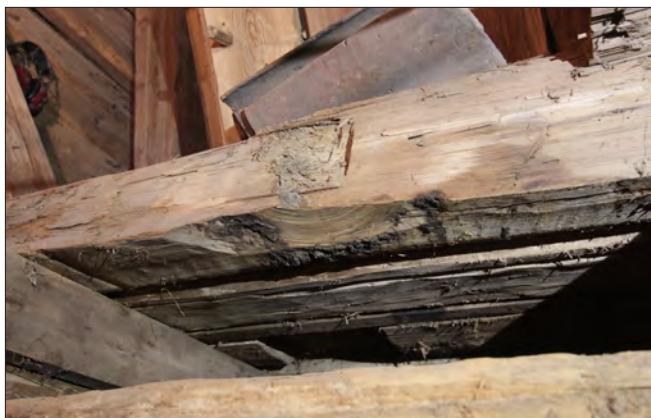
Figur 8. Delar av en bjälke med bortspjälkat virke har slitspår som eventuellt kommer från en klockupphängning.
