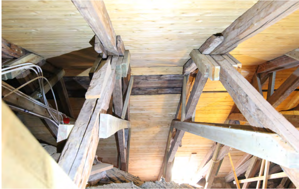
Dingtuna kyrka, långhusets nordvästra takfall. Återanvända medeltida delar i en yngre konstruktion tillsammans med sentida förstärkningar. I stort sett hela taktron mot nordväst är utbytt mot modern råspont.
