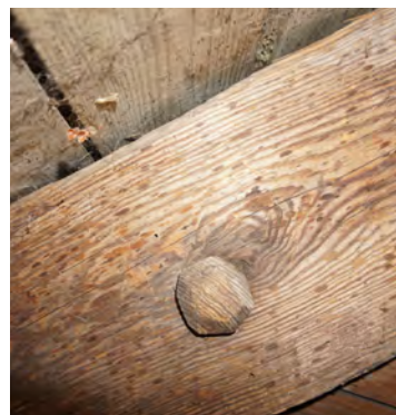
Kor. Spikskalledymning mellan bindbjälke och högben. Foto: T. Mårud.
