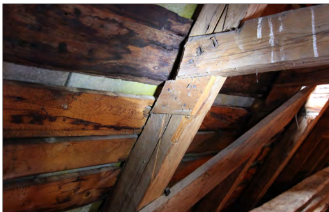
Figur 14. I högbenet på takstol nr 6, södra takfallet, syns spåren efter var delar tidigare suttit. I det medeltida urtaget för hanbjälken har en brüdlapp spikats fast och över den sitter en sekundär hanbjälke. Under det äldre urtaget syns en tunn urskärning i virket där en förmodad konstruktionsdel till treklövervalvet varit infäst.
