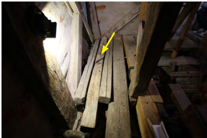
En av de löst liggande bjälkarna har ett snett urtag, markerad med gul pil. Den bedöms som medeltida.
