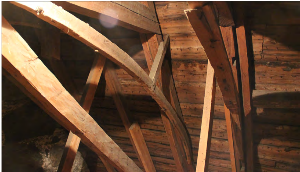
Figur 18. Valvbågar mellan högben och hanbjälke i västra delen av långhuset, norra taksfallet. Stickspärren mellan valvbåge och högben har skjutits ur sitt läge. Valvbågen till höger i bild har salats på som en kompensering för felaktig placering av valvbågen, dess undersida är bearbetad med skave.
