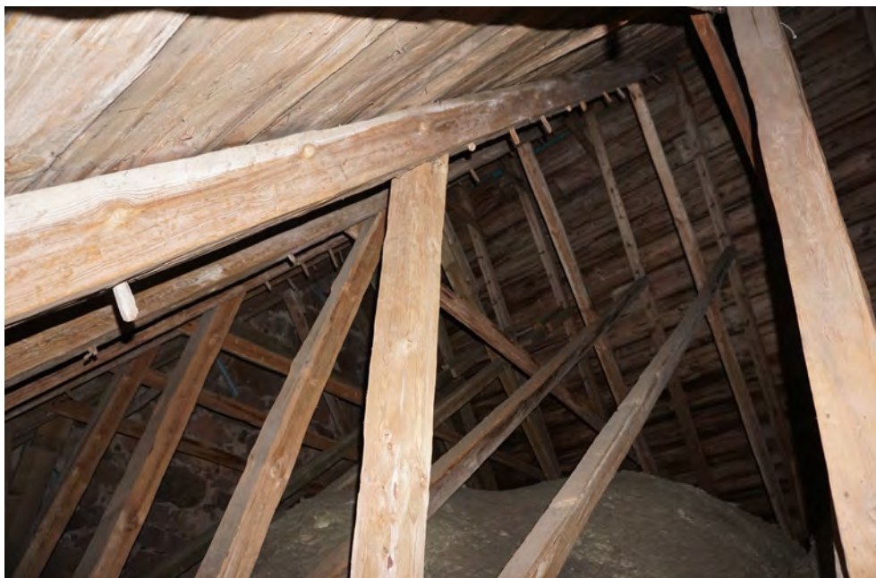
Takstolar över korvinden, tidigare långhus. Foto taget mot nordväst från glugg i södra takfoten. Foto: Tobias Mårud.
