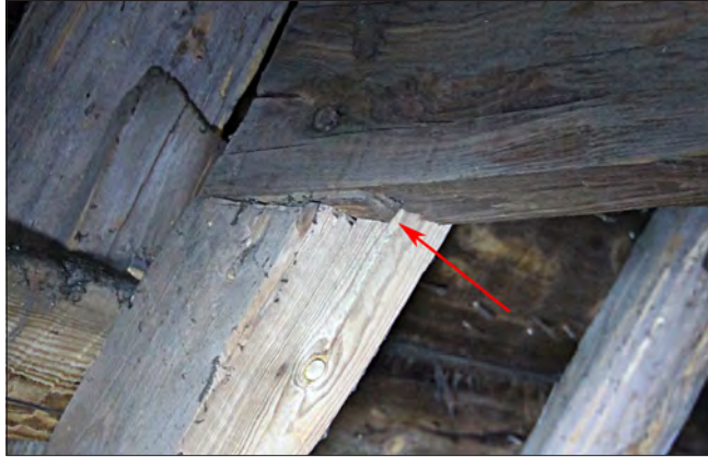
Figur 22. Knutpunkt högbenhjärke som kälats i takstol nr 20, södra takfallet.
