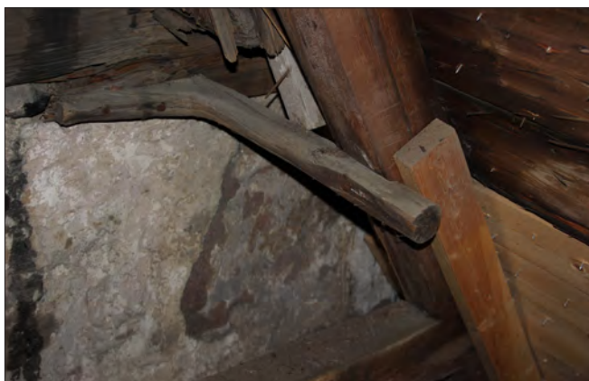
Figur 37. En av vapenbusets takstolar är förankrad i långhusets remstycke med ett rotben.
