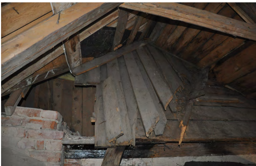
Foto taget på sakristians vind. Det som syns är långhusets äldre bräntak som bevarats. Sakristian är ombyggd, taket har höjts och byggnadskroppen har breddats. Foto: Daniel Eriksson.
