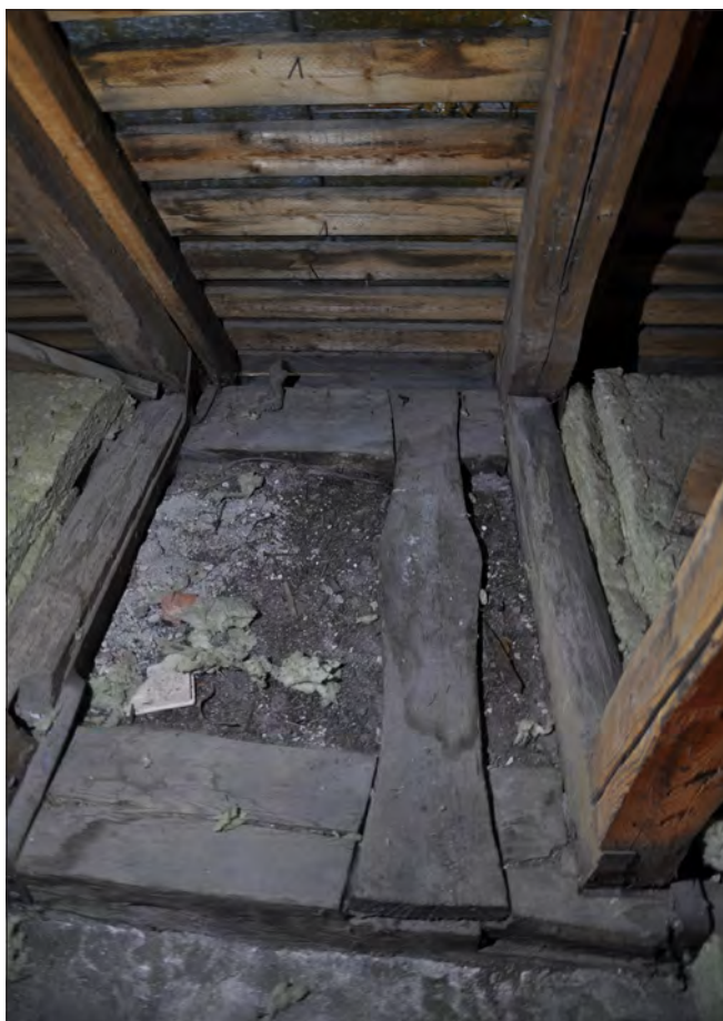
Figur 9. Inlaxad kortling av plank mellan yttre och inre remstykke intill takstol nr 27, södra murkerönet. Foto Daniel Eriksson.
