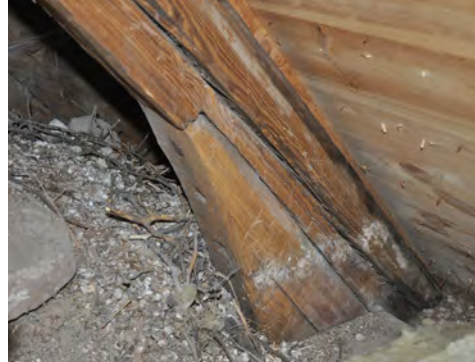
En del högben har en påspikad kloss istället för stickbjälke. Foto: Daniel Eriksson.
