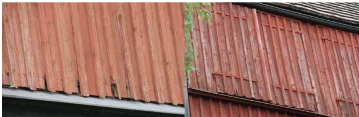
Figur 5 och 6 ovan. KM15093_009 och 011. Närbilder på skador i nederkant av panel i nedre panelfältet och på skador i ljudluckorna.
