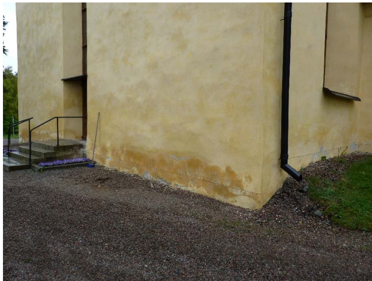
Figur 12. Muren söder om entrén i västra gaveln innan restaurering. Kraftigt flammig av fuktrosor. Foto: Tobias Mårud.
