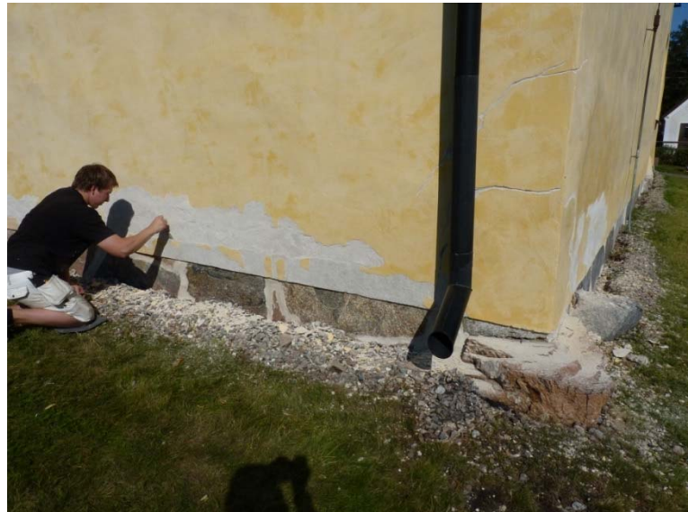
Figur 23. Sydöstra hörnet under börnet under pågående renovering av fasadputs. Observera ritsningen av sprickor synliga höger om stupröret. Foto: Tobias Mårud.
