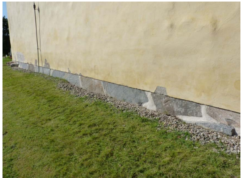
Figur 18. Här har samma parti fogats men fasaden har ännu inte åtgärdats. Foto: Tobias Mårud.
