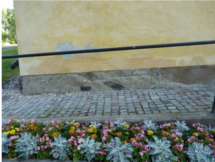
Figur 22. Norra delen av sockeln på västra gaveln krävde omfattande putsning. Foto: Tobias Mårud.
