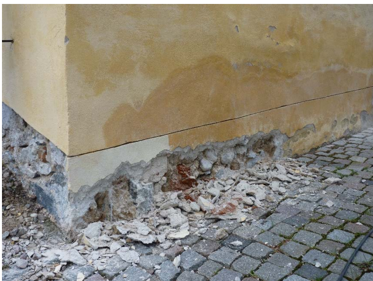
Figur 21. Hörnet på norra delen av sockeln på västra gaveln har möjligen skadats och murats upp med mindre stenar än ursprungligen. Foto: Tobias Mårud.
