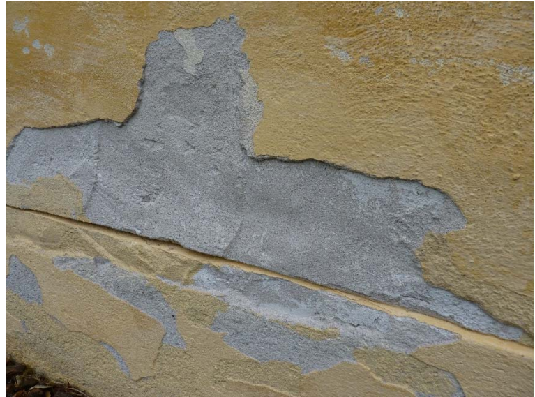
Figur 16. Skada på norra fasaden som visar exempel på underliggande överbearbetad puts. Foto: Tobias Mårud.
