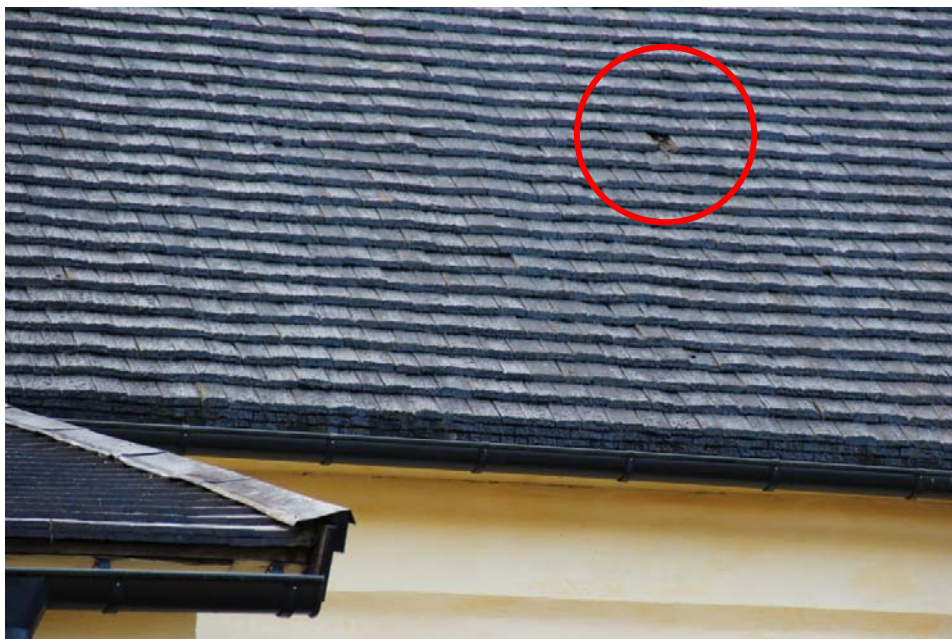
Figur 35. Saknat spån på norra takfallet inringat. I bildens nedre vänstra kant syns sakristians tak. Foto: Helén Sjökvist.
