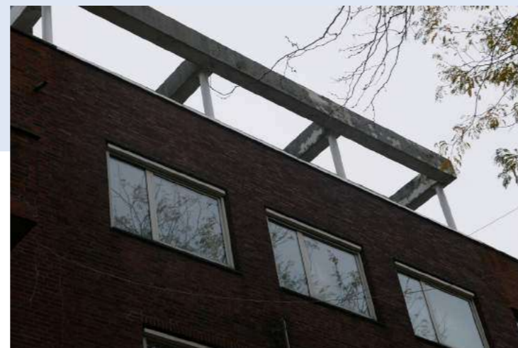
Voorbeeld huidige situatie: Verf pergola bladdert af.
