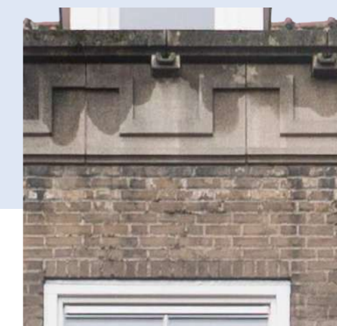
Voorbeeld huidige situatie: dauerlftung bij de ramen, ernstige vervuiling onder de fries
