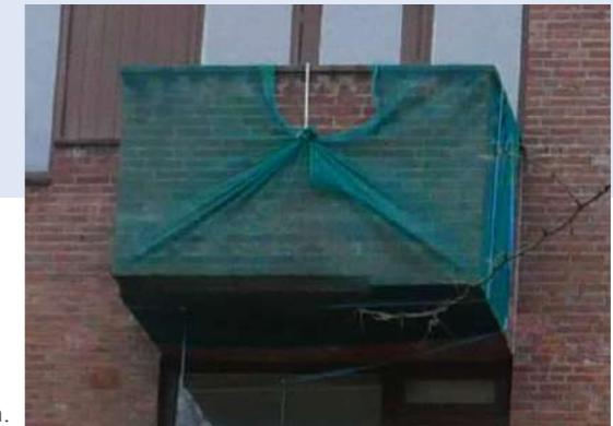
Balkon ingepakt vanwege valgevaar losse bakstenen.
