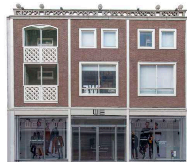
Demer 42 verwijderen luifel, vervangende reclame verwijderen gaas in loggia veiligheidscontrole balustrade dakrand vervangen rolscherm door pui met entree-deuren opschonen en reinigen gevel verdiepingen terugbrengen omkadering etalage zoals origineel
