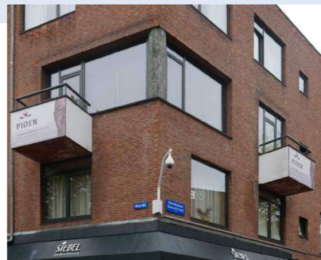
Voorbeeld huidige situatie: Reclameplaten op de balkons, vochtschade aan het metselwerk
