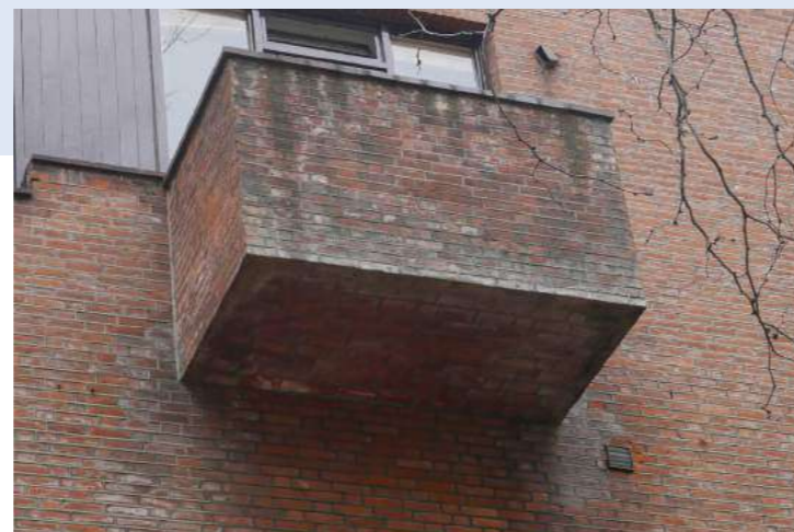
Boven: ander perspectief dakrand Onder: voorbeeld huidige situatie, schade aan balkon
